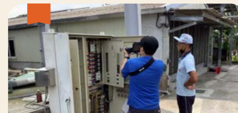
圖 4-21、企業損防顧問電氣設備安全檢測（紅外線）
